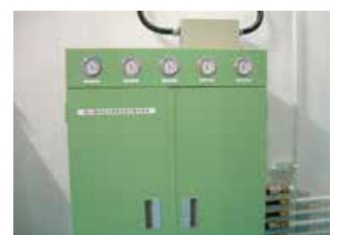
エア配管パネル
