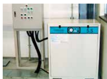
電気操作盤・コンプレッサー
