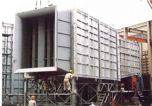
ガスタービン吸気サイレンサー
