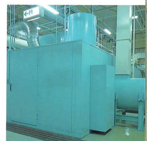
原料風送ライン防音システム
